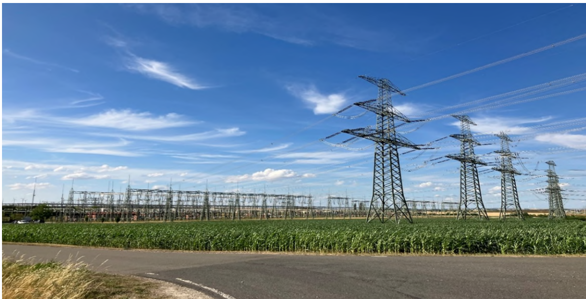
Abbildung 2: Umspannwerk Wolkramshausen (Quelle: Eigenaufnahme von der Ortsbegehung am 12.07.2023)
